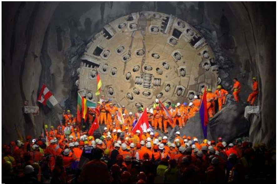
Bildo 5: Ĉe la bazo de giganta tunel-bormaŝino, laboristoj festas la kunligon de du tunel-partoj. Observante la standardojn, notu la internaciecon de la dungitaro.
